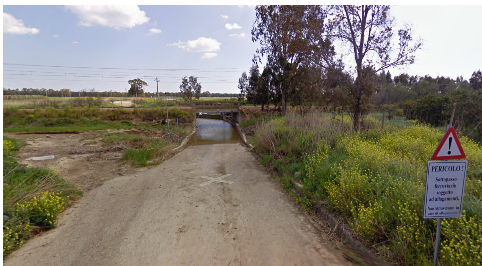
Figura 21 – sottopasso ferroviario esistente allagato – foto Google street
