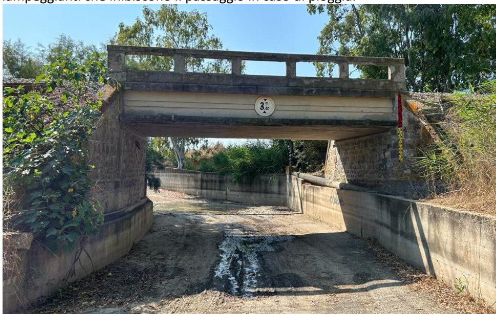
Figura 19 – Sottopasso ferroviario esistente con fanghiglia depositata sul fondo – sopralluogo giugno 2023
