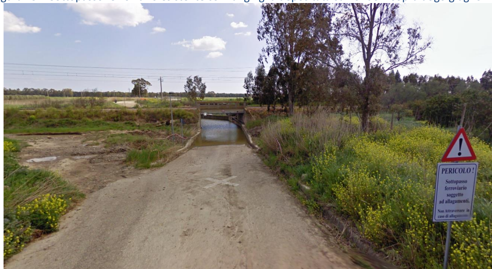
Figura 20 – Sottopasso ferroviario esistente allagato – foto Google street
