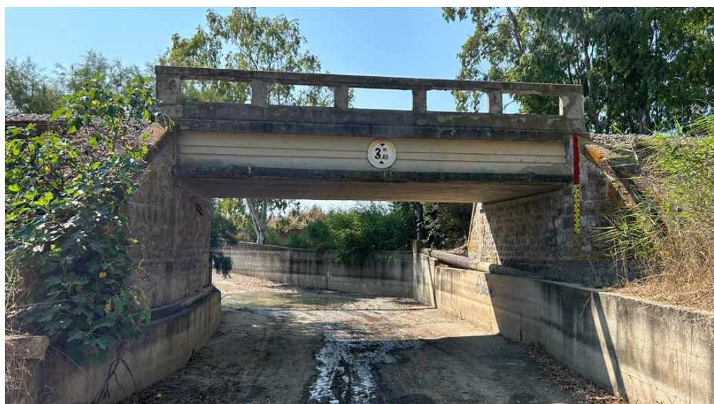
Figura 20 – sottopasso ferroviario esistente con fanghiglia depositata sul fondo – sopralluogo giugno 2023
