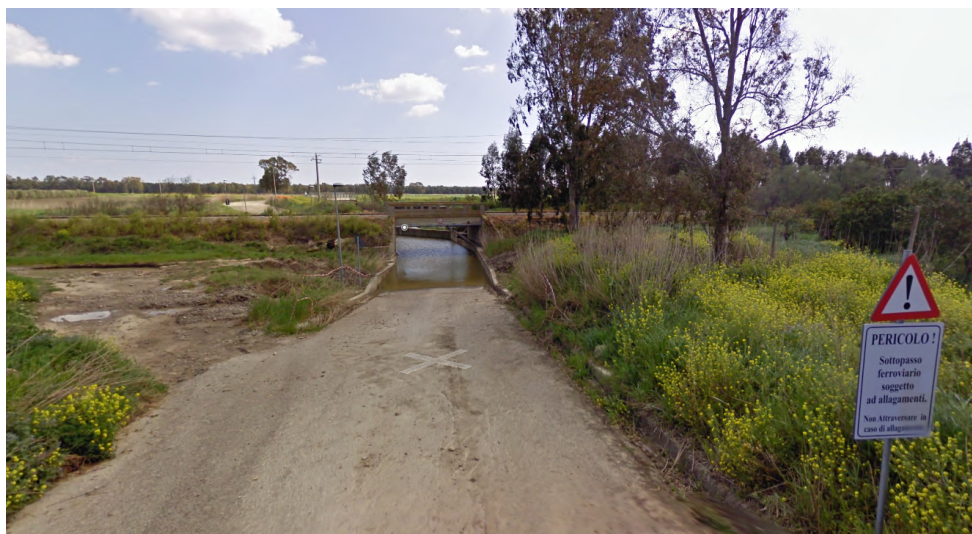
Figura 21 – sottopasso ferroviario esistente allagato – foto Google street
