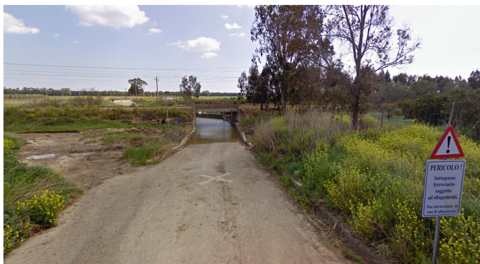
Figura 18 – sottopasso ferroviario esistente allagato – foto Google street
