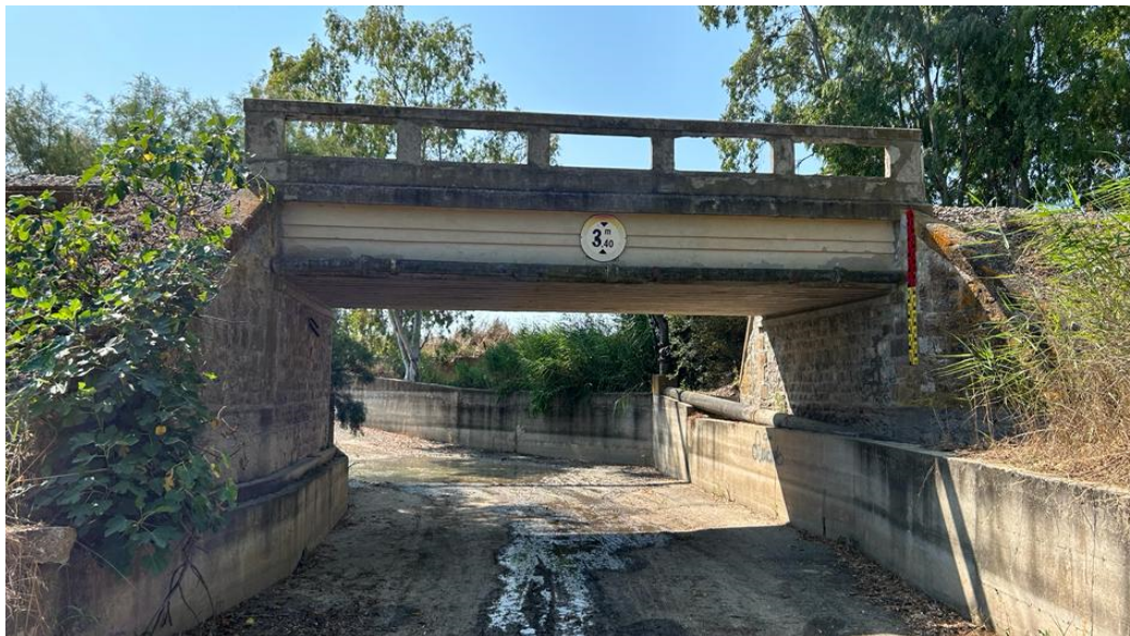
Figura 17 – sottopasso ferroviario esistente con fanghiglia depositata sul fondo – sopralluogo giugno 2023
