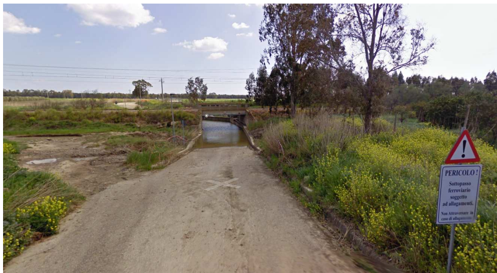
Figura 17 – sottopasso ferroviario esistente allagato – foto Google street
