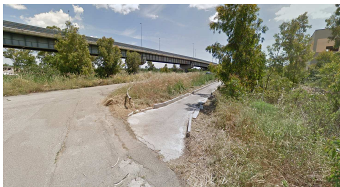
Figura 2 – Percorso pedonale esistente da adeguare
