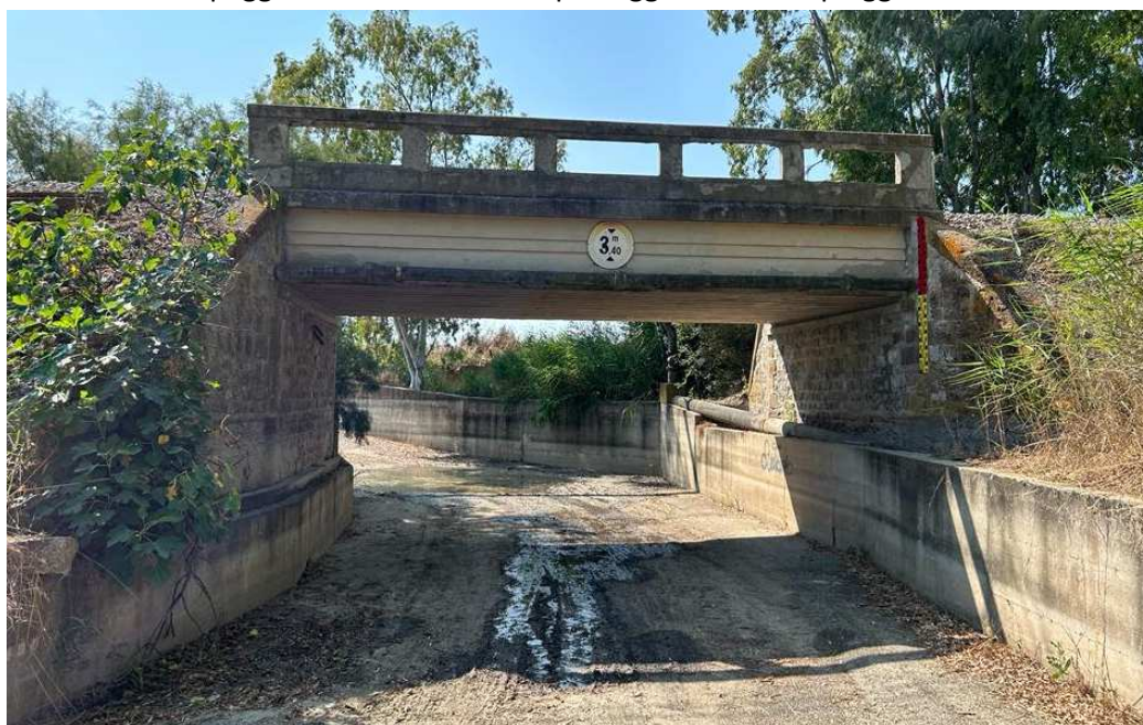
Figura 16 – sottopasso ferroviario esistente con fanghiglia depositata sul fondo – sopralluogo giugno 2023
