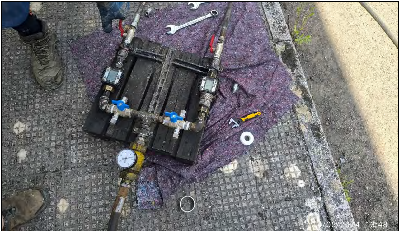
Particolare del sistema di iniezione – Contabilizzazione su doppia linea
