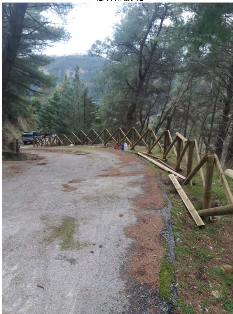
Foto 10 – Tratto di strada asfaltata con staccionata in fase di realizzazione nella fustaia di conifere di località Paschiera (Foto Paolo P.)
